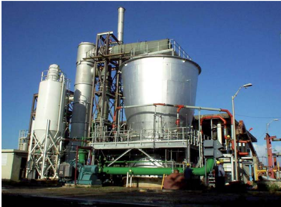
Instalación de incineración de lodos en Puerto Rico Horno Degrémont Thermylis
